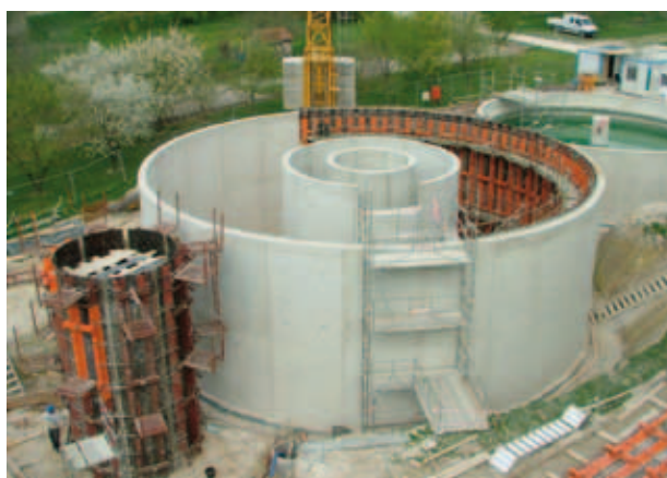
Bassin d'aération : ouvrage principal permettant le traitement biologique des eaux usées
